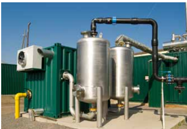
Zwei Aktivkohlefilter reinigen das Biogas. Dann wird ein Teil direkt in Samswegen verstromt und ein anderer Teil zum Satelliten-BHKW nach Meseburg geleitet.
