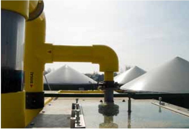
Die neue Gasdrucksicherung (links im Bild) ist auf dem liegenden Fermenter angebracht. Im Hintergrund sind die drei gründlich erneuerten weiteren Fermenter zu sehen.
