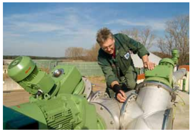
Als örtlicher Betriebsführer wartet Gerald Heinemann unter anderem die neue Stopfschnecke der Anlage.
