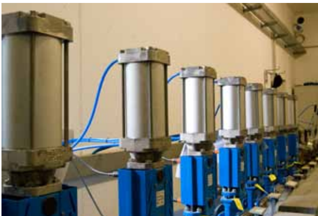
Neue Pneumatikschieber regeln die Verteilung der Substrate.
