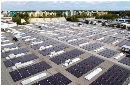
Foto: PV-Dachanlage mit 1.500V Systemtechnik auf dem Hybridkraftwerk Berlin - Marienfelde
