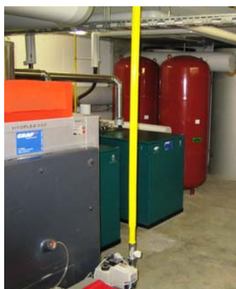
Energiezentrale im DEMAX-Demonstrationsobjekt. Quelle: Fraunhofer ISE
